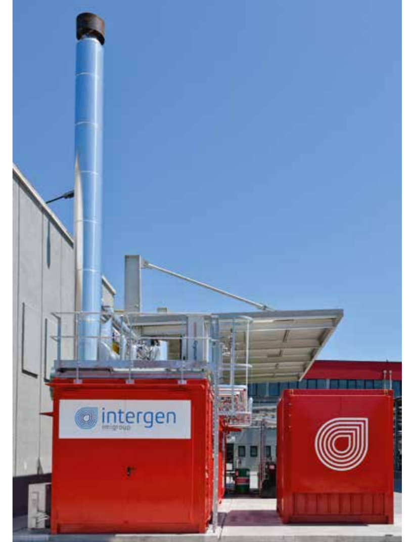
L'IMPIANTO DI COGENERAZIONE INSTALLATO ROVAGNATI NELLO STABILIMENTO DI VILLASANTA (MB)
