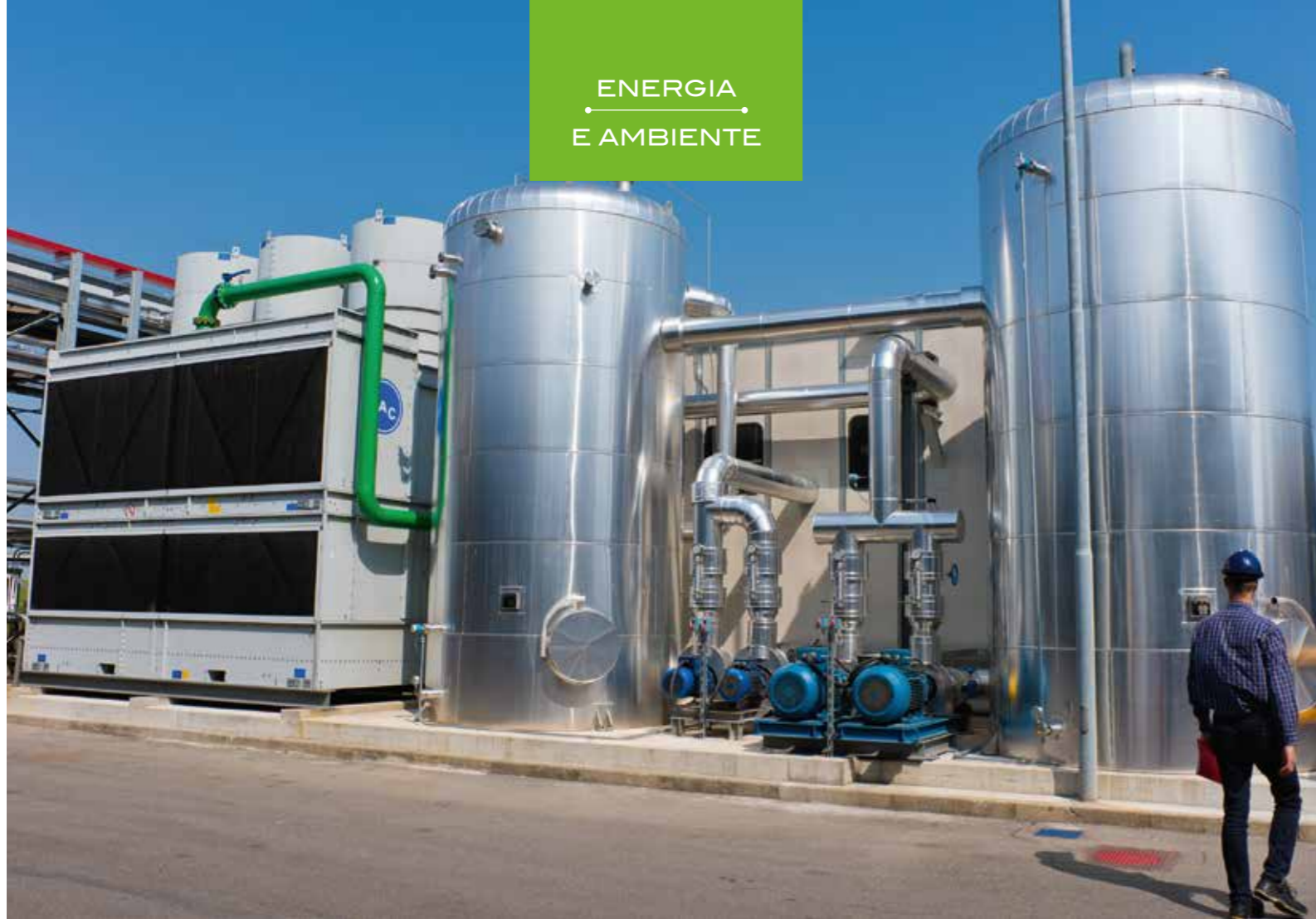
IMPIANTO REALIZZATO PRESSO L'IMPIANTO LAMBERTI DA ALBIZZATE (VA)
